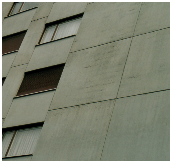
Enrobage insuffisant généralisé
