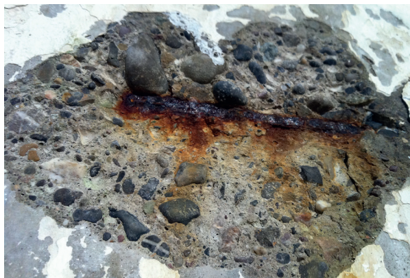
Eclatement du béton provoqué par la corrosion de l'armature
