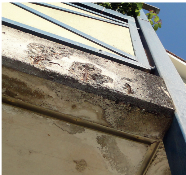
Enrobage insuffisant par endroits
