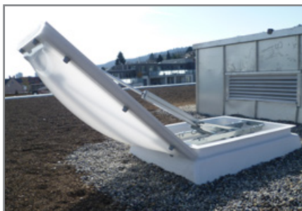
RWA-Oblichter inkl. Steuerungen und technischer Planung
