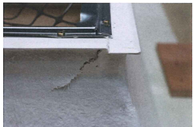
Abbildung 16: Oblicht Nr. 1 mit Gitter Nr. 2 nach dem Versuch. Lokaler Bruch.
