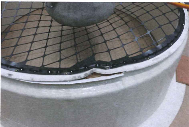
Abbildung 19: Oblicht Nr. 4 nach dem Versuch. Bruchstelle links.
