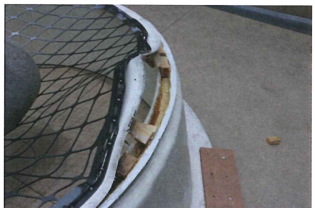
Abbildung 20: Oblicht Nr. 4 nach dem Versuch. Bruchstelle rechts.
