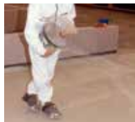
8. Für einen besseren Haftverbund wird eine zusätzliche Nuttschicht mit Triflex ProPark aufgetragen und mit Quarzsand abgestreut.
