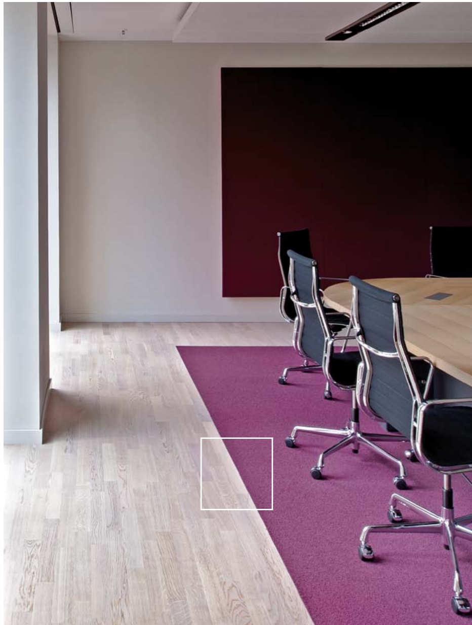
Absence de joints lors du passage du parquet à la moquette ...
